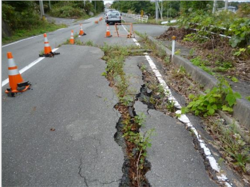
浪江町の道路の被災状況
