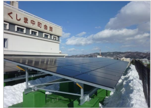
会館屋上の太陽光発電パネル (CIS型/公称出力26kW/南向き/設置角度10°)
