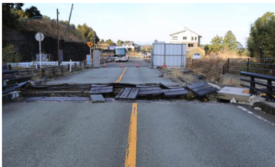
（上）桁が橋軸直角方向に移動した大切畑大橋 （右）崩壊した斜面（阿蘇地区）
