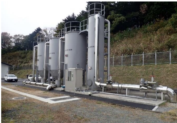
(竣工後:原水に含まれる懸濁物質を除去するために設置した前処理ろ過設備)
