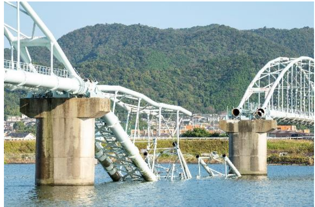
和歌山市六十谷水管橋 落橋後の状況 (国土交通省近畿地方整備局HPより引用)
