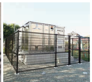
公営住宅給水設備改修工事(設計・積算・工事監理業務)
